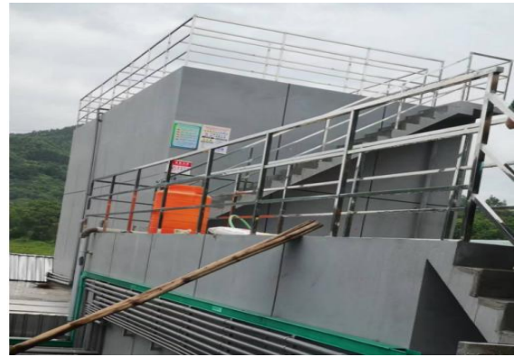
项目废水处理设施
